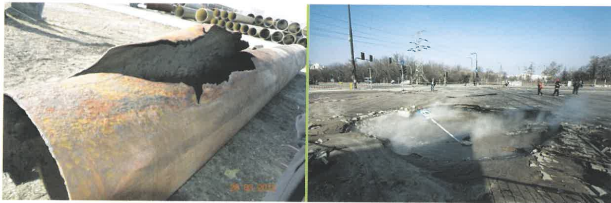
Rys. 3. Awaria rury przewodowej DN1000, zamknięcie na kilka miesięcy jednego ze strategicznych skrzyżowań w mieście Fig. 3. Failure of a DN1000 pipeline, a strategic crossroads was closed for a few months
