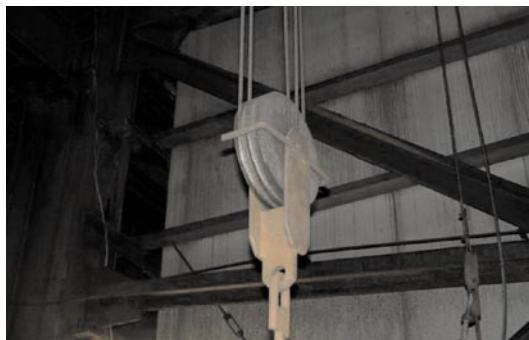
Rys. 10. Lina opasująca poza kołem roboczym zamocowania wielokrążkowego rurociągu pary do wtórnego przegrzewu bloku 200 MW
