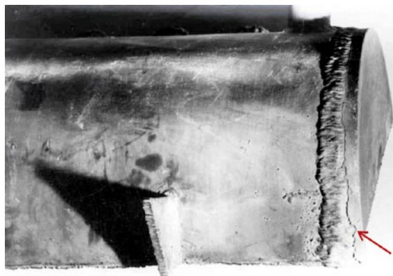
Rys. 2. Komora wylotowa przegrzewacza pary wtórnej II° kotła OP-650k. Deformacja denka z pęknięciami spoiny obwodowej spowodowana naprężeniami zmiennymi.
