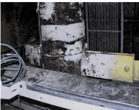
Rys. 16. Obejma pionowa o zbyt małej sztywności
