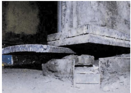
Rys. 17. Zbyt mała jezdnia dwukolumnowej podpory pionowej, która dodatkowo nie uwzględnia odchylenia rurociągu od pionu: a) zbyt mała powierzchnia jezdni powoduje wysuwanie się zespołu kulowego b) brak przegubu uchylnego dwukolumnowej podpory kulowej powoduje, że jedna ze stóp unosi się w górę o kilkanaście mm
