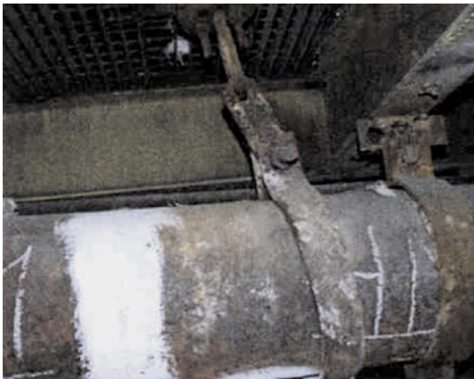
Rys. 15. Blokada montażowa pozostawiona przez ekipy remontowe – sąsiadujące z nią zamocowanie „wyłączone z pracy”
