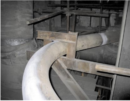
Rys. 14. Blokada montażowa pozostawiona przez ekipy blokujące rurociąg
