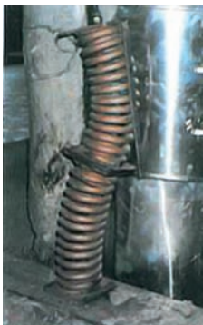
Rys. 1. Żle dobrany udźwig zamocowania sprężynowego jednokolumnowego
