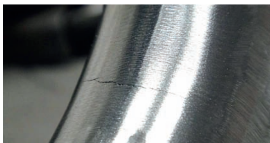
Rys. 5. Pęknięcie w strefie ściskanej kolana węzownicy
