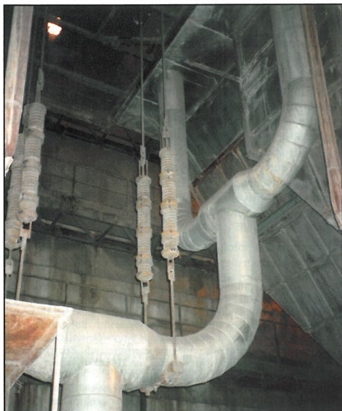
Rys. 3. Zawieszenie dwukolumnowe sprężynowe (trójników przed komorą wlotową podgrzewacza wody kotła OP-650) rurociągu wody zasilającej
