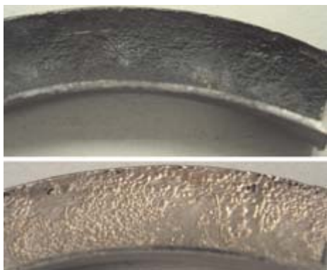
Rys. 8. FAC na powierzchni wewnętrznej rur miedzioniklowych o małym promieniu gięcia
