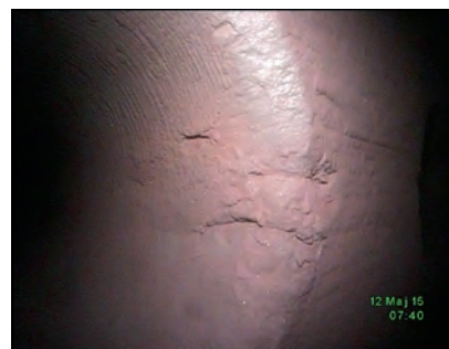
Rys. 10. Pęknięcie krawędzi otworu / mostka obwodowego komory
