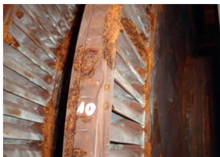
Rys. 11 Korozja postojowa. Turbina 100 MW, wirnik NP
