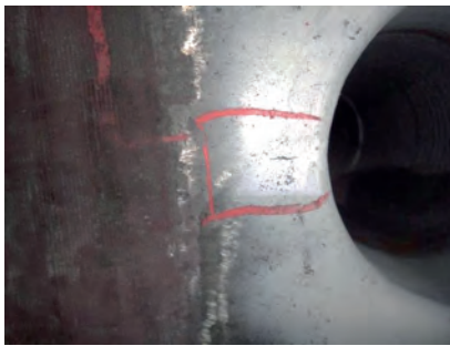
Rys. 6. Pęknięcia na krawędzi otworu pod rurę opadową w strefie wodnej walczaka
