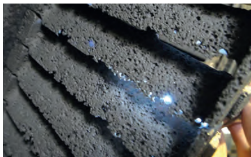
Rys. 14. Układ łopatkowy wirnika turbiny 30 MW porażony korozją postojową
