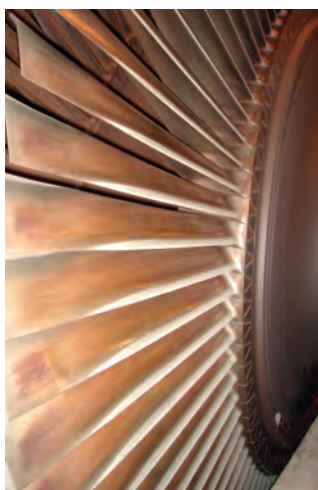
Rys. 10 Ubytki erozyjne na krawędziach wylotowych. Turbina 120, wirnik NP
