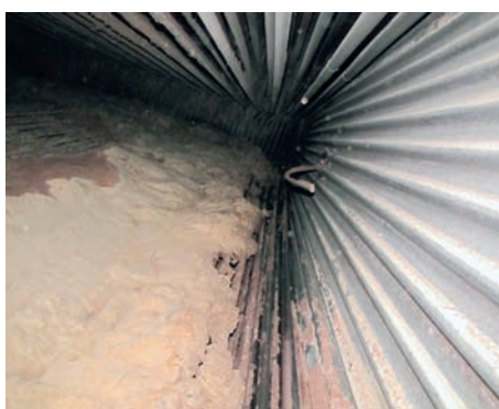
Rys. 7. Szlakowanie rur ekranowych jako rezultat spalania biomasy oraz pracy kotła z licznymi uruchomieniami i obniżonym minimum technicznym
