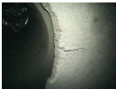
Rys. 5. Pęknięcia koszulek schładzaczy
