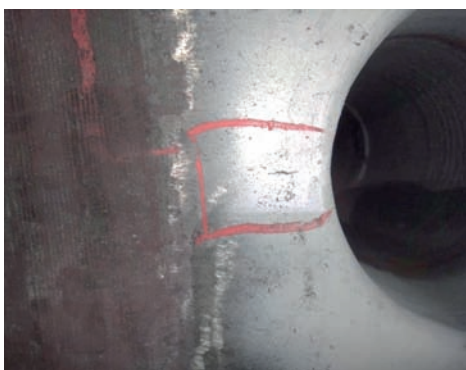
Rys. 4. Pęknięcia na krawędzi otworu pod rurę opadową w strefie wodnej walczaka Źródło: opracowanie własne
