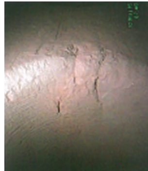
Rys. 6. Pęknięcia krawędzi otworu w komorze
