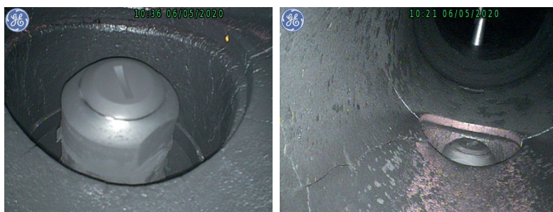
Rys. 5. Schładzacz II° – pęknięcia na koszulce ochronnej oraz krawędzi i tworzącej otworu pod lancę aparatu wtryskowego
