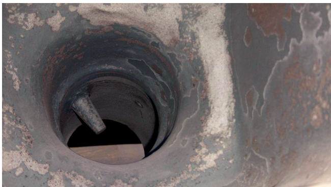
Rys. 3. Wnętrze komory zaworowej udostępnionej do badań – obszary z grubą warstwą zgorzeliny
