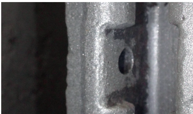
Rys. 8. Niedoczyszczona studzienka zamkowa
