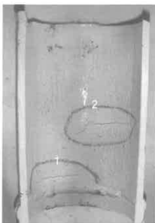
Rys. 2. Obwodowe pęknięcia rurociągu od strony wewnętrznej w pobliżu spoin obwodowych (1) i pachwinowych (2) Fig. 2. Circumferential cracks on the inner side of the pipeline near the butt circumferential joints (1) and fillet weld (2)
