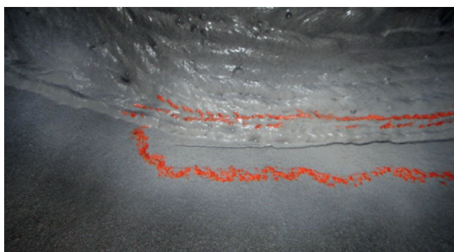
Rys. 1. Pęknięcie w SWC spoiny naprawczej
