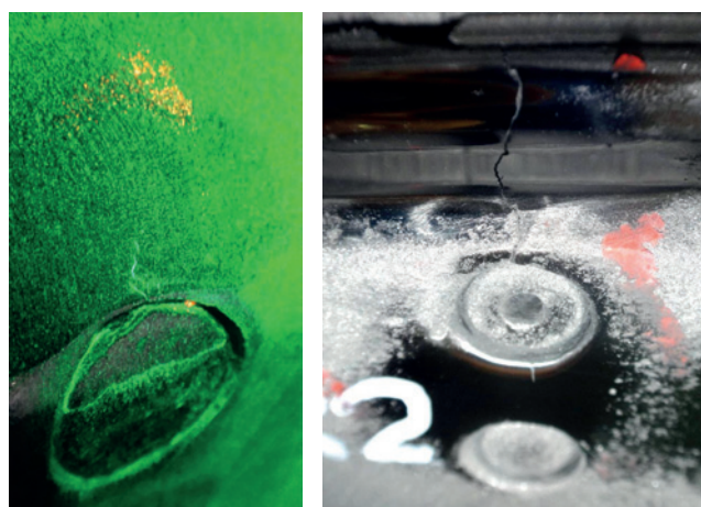
Rys. 7. Pęknięcia na krawędziach otworu pod kołek łopatki zamkowej
