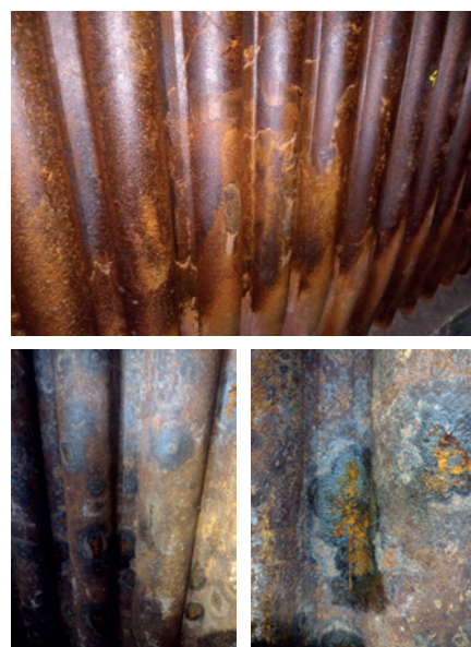
Rys. 2. Powierzchnia rur ekranowych kotła fluidalnego po odstawieniu w 2022 roku
