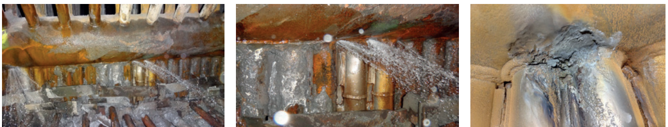
Rys. 4. Skutki kolejnej awarii komory pośredniej ekranu tylnego – pęknięcia połączeń spawanych i uszkodzenia wtórne spowodowane wpływającym czynnikiem Źródło: CIECH Soda Polska S.A.
