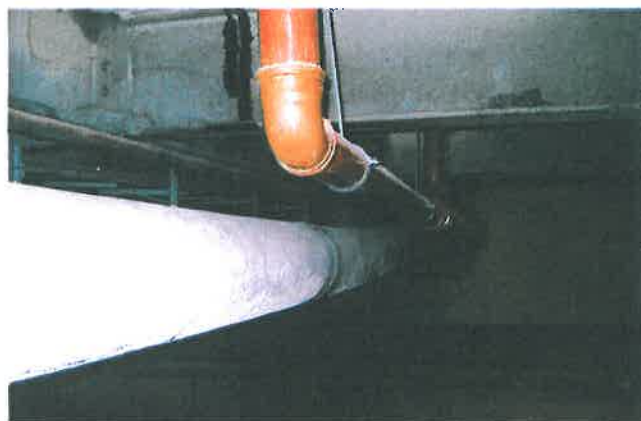
Rys. 11. Ugięty długi poziomy odcinek rurociągu pary świeżej
