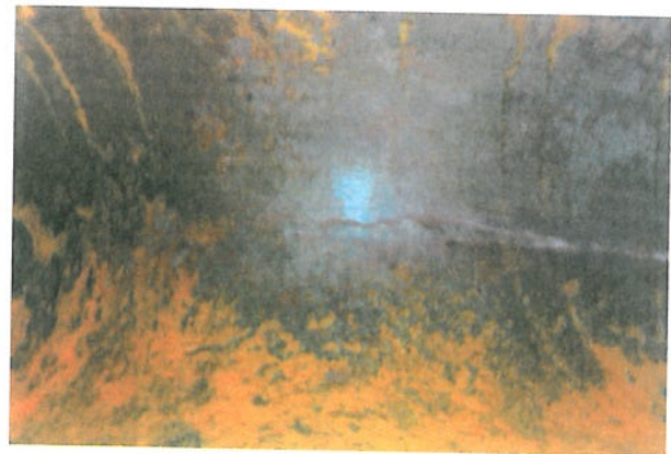
Rys. 3. Wewnętrzna powierzchnia czwórnika rurociągu pary świeżej od strony wlotu pary
