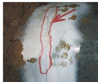
Rys. 1. Obwodowe pęknięcia spoin rurociągu w strefie wpływu ciepła [9, 10]
