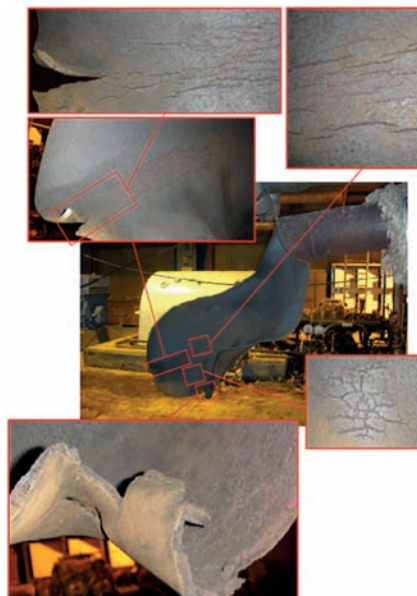
Rys. 5. Awaria kolana części średnioprężnej rurociągu wody zasilającej
